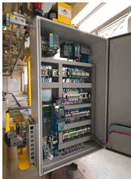
④ „Mitfahrzentrale“: Jeder Fahrwagen hat einen eigenen Schaltkasten mit einer dezentralen Steuerung aus dem Programm Simatic ET 200S; antreibende Kraft ist jeweils ein Einachs-Umrichter Sinamics S110
