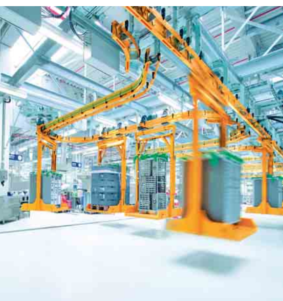
1 Elektrohängebahnsysteme mit flexibler, durchgehender, weltweit verfügbarer Automatisierungstechnik haben sich branchenübergreifend etabliert
